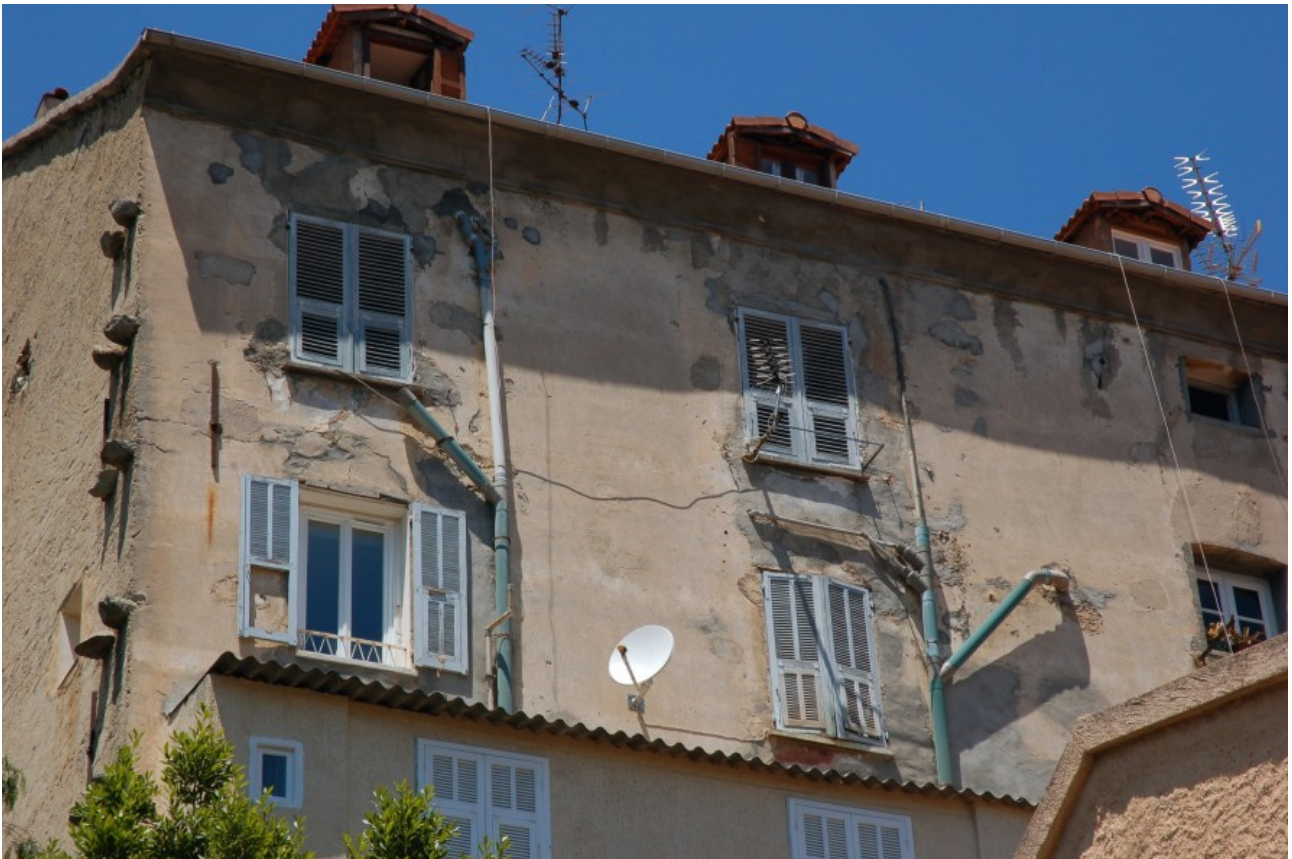
005 Kanalizacijske cevi po zunanjih stenah dajejo slutiti, da se ne bojijo pretirane zime, estetika pa jim ni mar.
